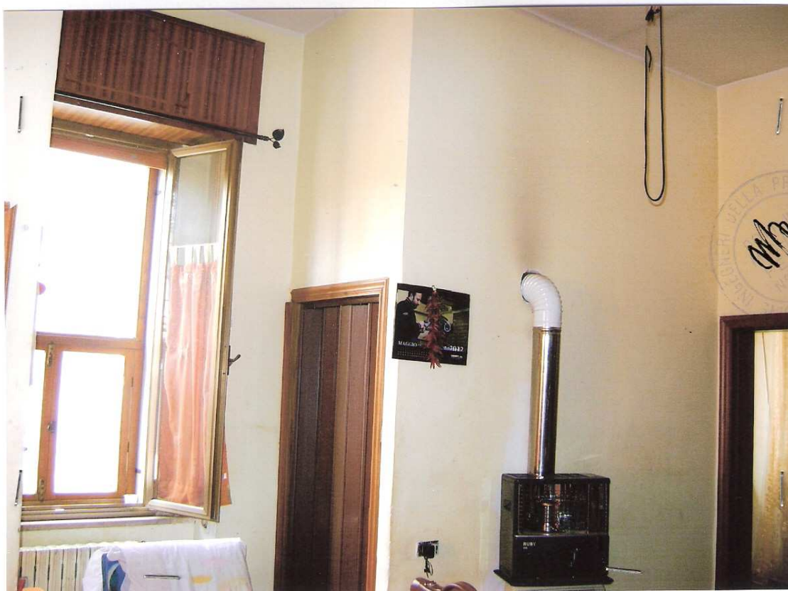
Foto n° 18 - LOTTO UNICO : Particolare rifiniture interne dell'immobile pignorato, civico n. 8 P.1°, via S. Antonio Abate – Serracapriola (FG).
