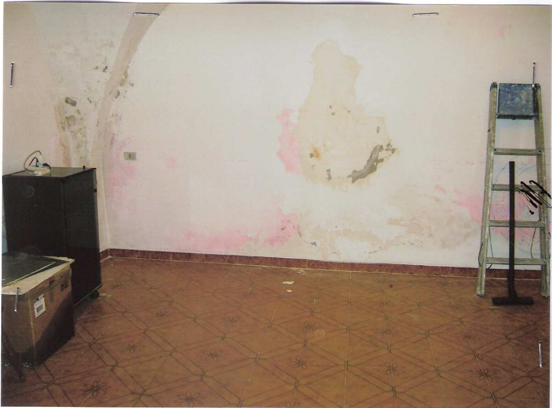
Foto n° 9 - LOTTO UNICO : Particolare rifiniture interne dell'immobile pignorato, civico n. 10 via S. Antonio Abate – Serracapriola (FG).
