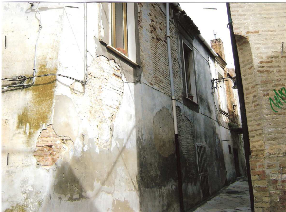
Foto n° 3 - LOTTO UNICO : Particolare prospetto immobile pignorato, visto da via Cavallotti – Serracapriola (FG).
